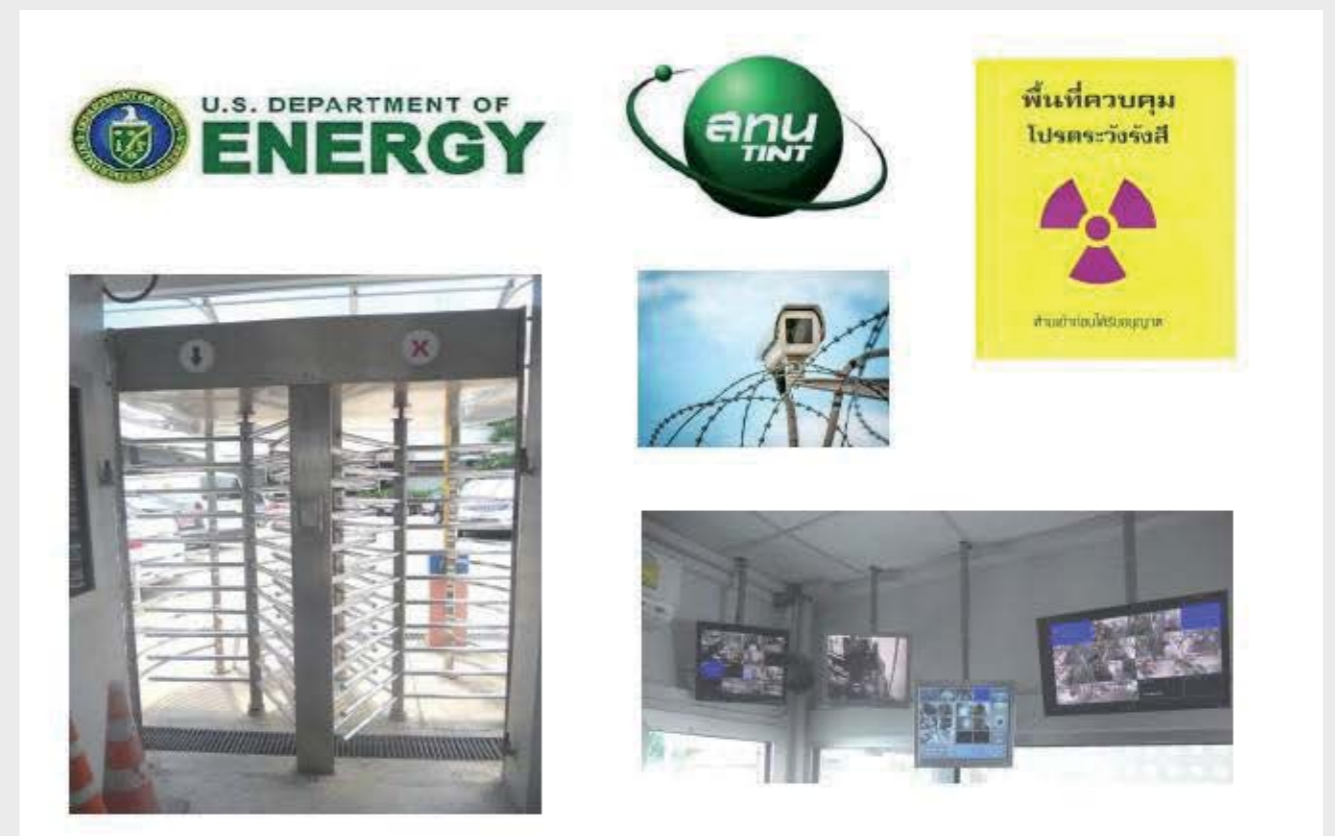
ภาพแสดงระบบรักษาความปลอดภัย 24 ชั่วโมง และระบบบันทึก CCTV ระบบการเข้า-ออก Access Control
