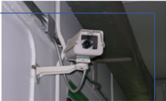
ระบบ CCTV
