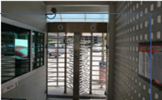
ระบบการเข้า-ออก Access Control เซตชั้นใน
